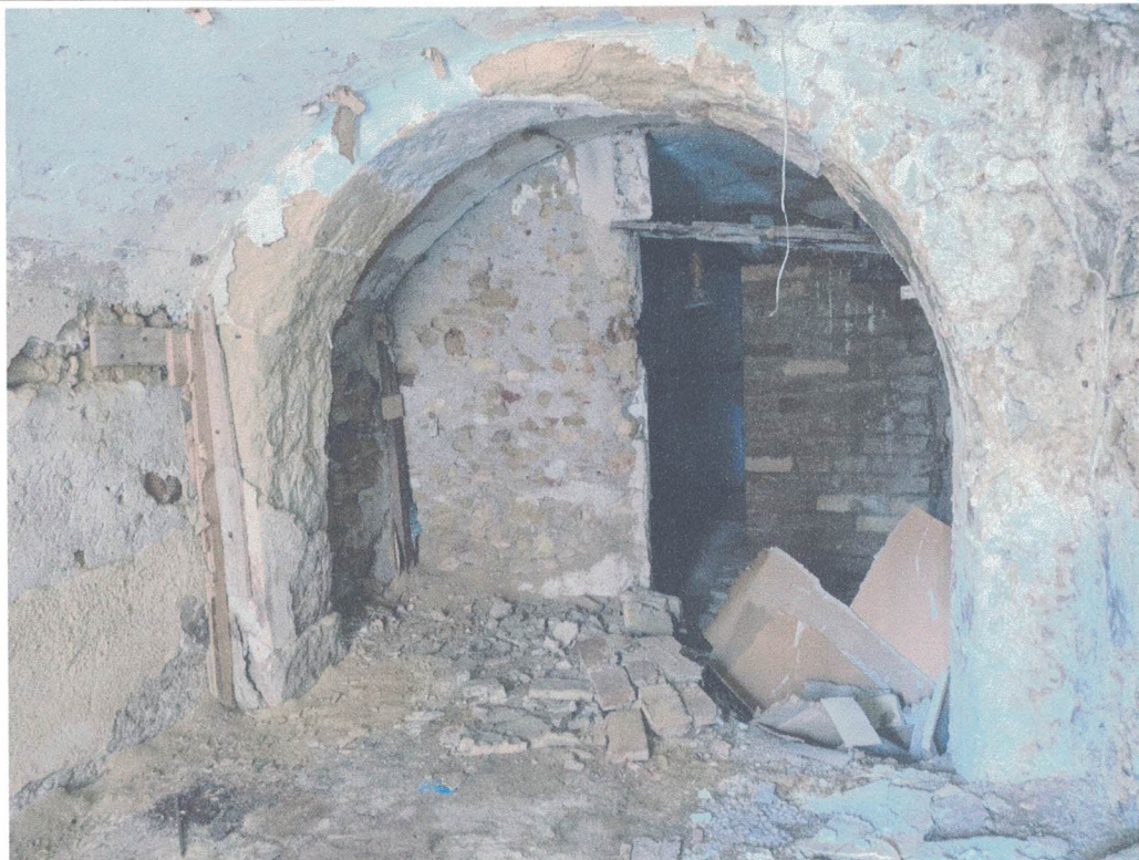
FOTO 9- Cedimento pavimentazione u.i.u. Via Calatafimi n. 13
