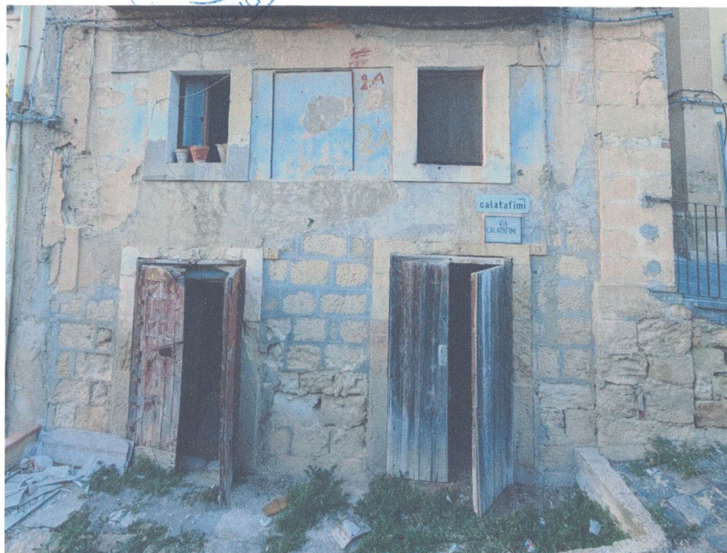
FOTO 7- Stato di conservazione prospetto su Via Calatafimi n. 12-13
