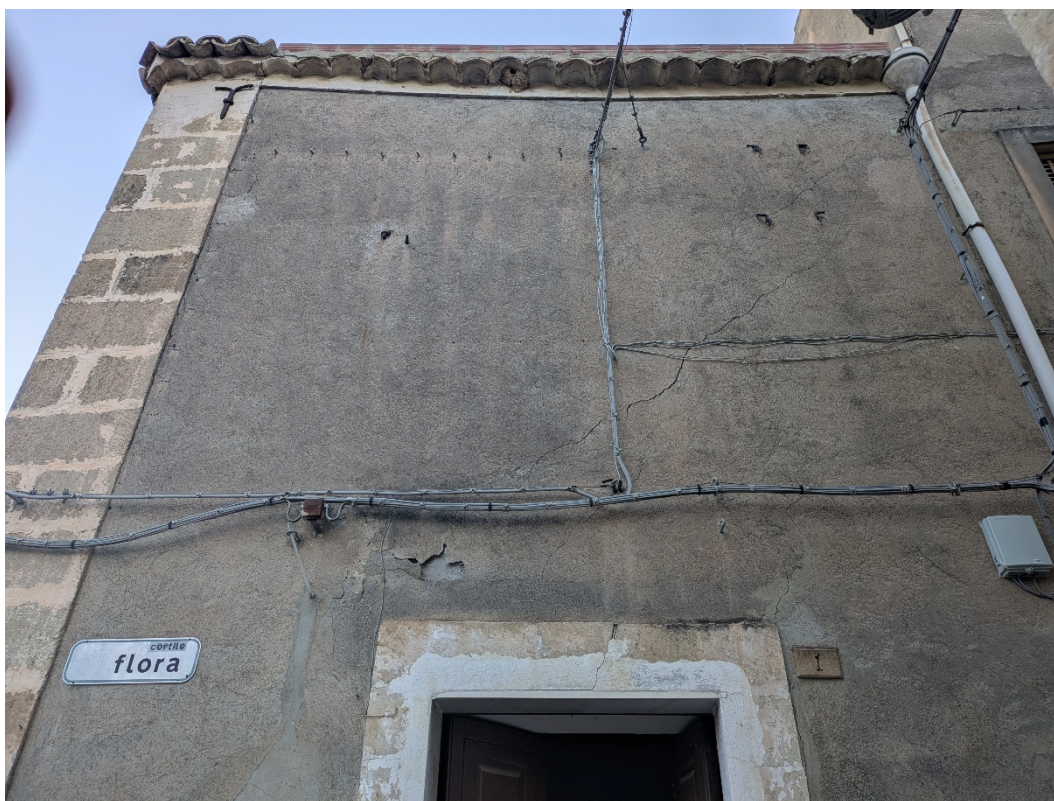
FOTO 8- Stato di conservazione prospetto su C.le Flora n. 1
